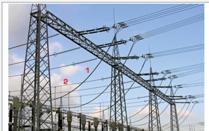
Câbles suspendus librement dans la réalité (portique d'ancrage): 1 hauban, 2 ligne de courant semblable à la ligne électrique aérienne
