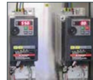
Frequenzumrichter zur Steuerung der Pumpen
