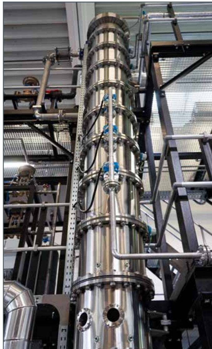
Procédé de distillation: colonne de rectification
