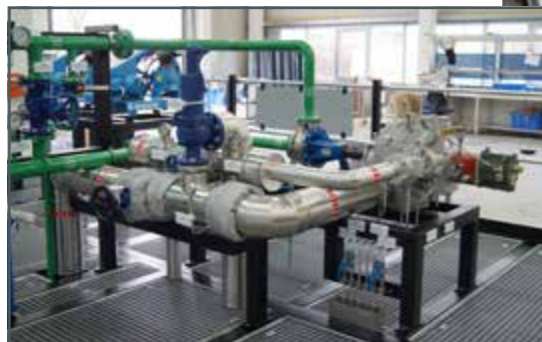
Station de pompage auxiliaire alimentée en vapeur
