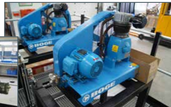
Station d'air comprimé
