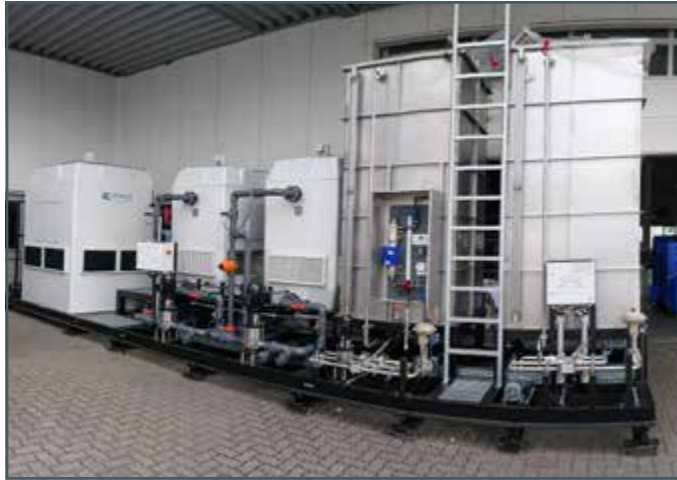
Tours de refroidissement humides et réservoirs de stockage pour l'eau de processus et l'éthylène glycol à l'extérieur
