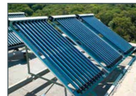
Capteurs à tubes montés avec un angle d'attaque optimisé sur un toit plat
