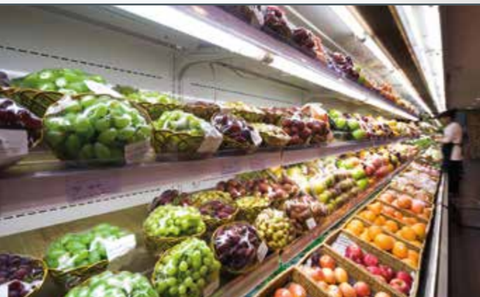
Application typique pour installations frigorifiques: les comptoirs de supermarché fonctionnent sur la plage de refroidissement normal.
