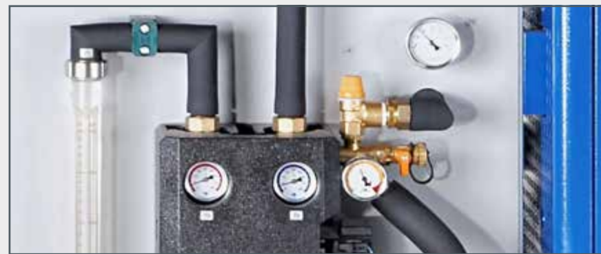
Le panneau du circuit solaire comprend une pompe de circulation et des composants essentiels à la fiabilité de fonctionnement.
