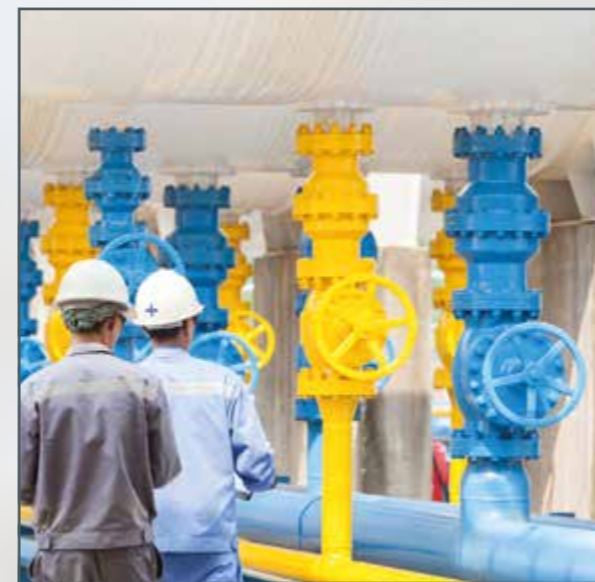
Robinetteries d'une station de distribution industrielle
