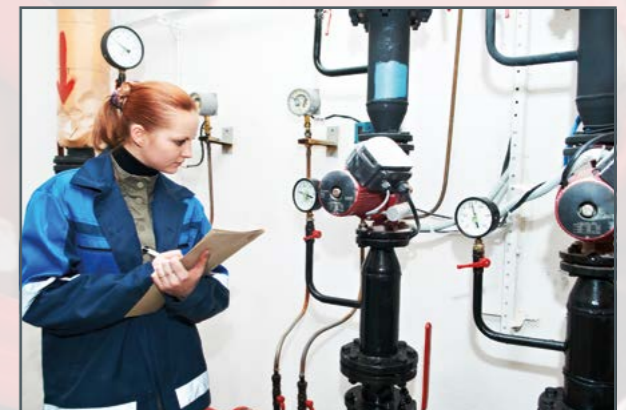
Kontrolle der Anlagenkomponenten
