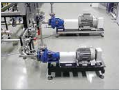
Station de pompage de HM 124
