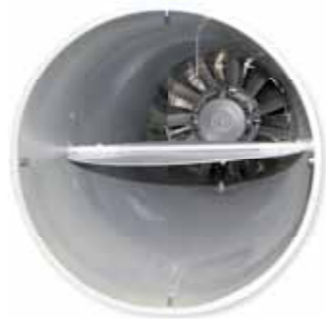
Drosselklappe am Ende der Messstrecke zur Einstellung des Volumenstroms.
