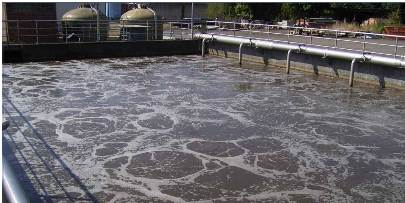
Biologische Reinigungsstufe auf einer Kläranlage (Belebungsbecken)
