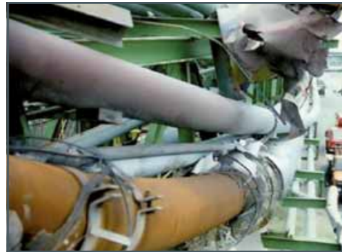
Tuyauterie et fixations détruites après un coup de bélier
