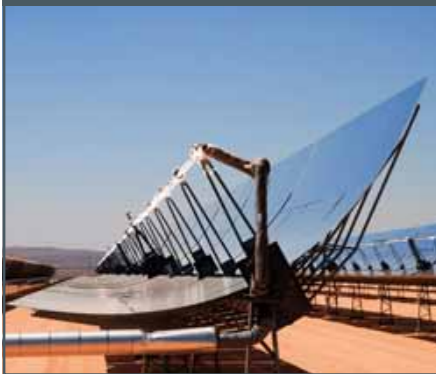
Centrale solaire et centrale thermique solaire
