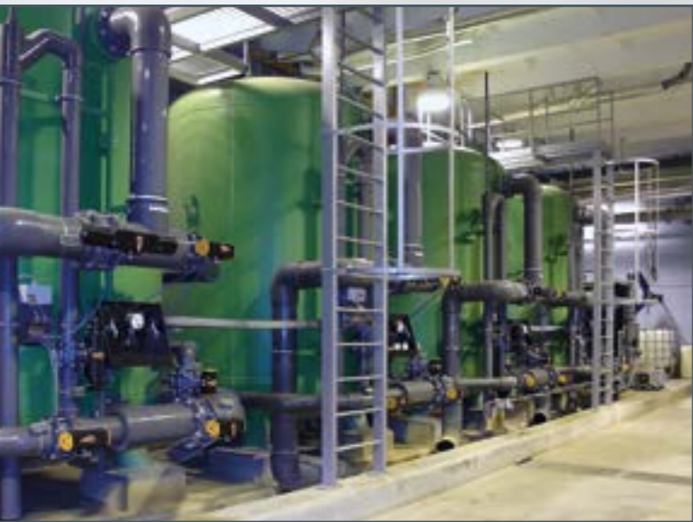
Adsorbants traversés en continu dans une station de traitement de l'eau
